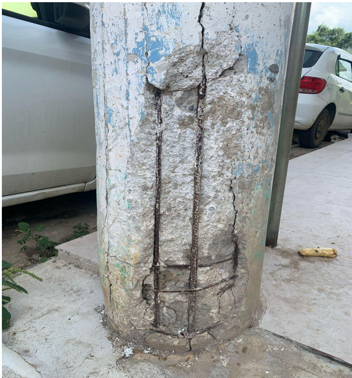
Figura 2 – Poste com armadura exposta e oxidada.
